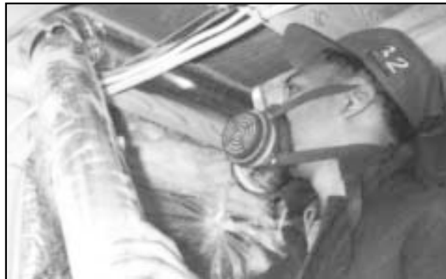
Los conductos de calefacción y aire acondicionado pueden acumular polvo que contiene plomo.
